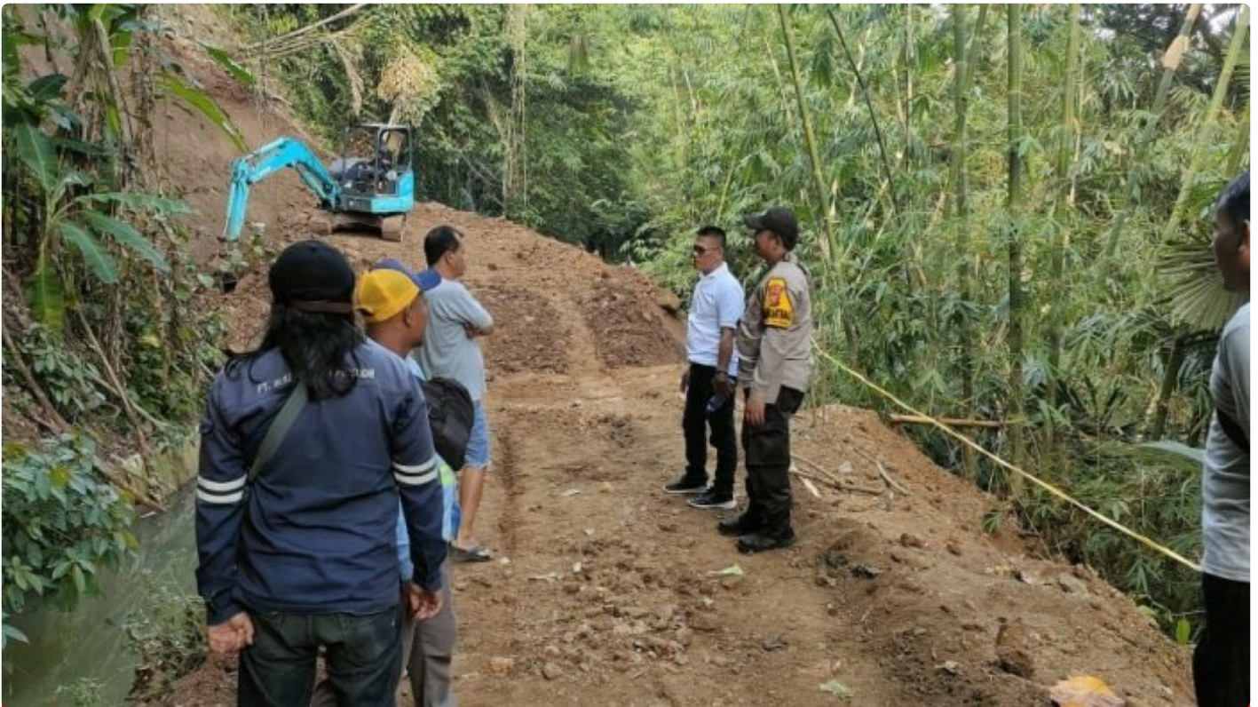
Bhabinkamtibmas Polsek Cikembar Bantu Warganya Keruk Saluran Irigasi Yang Tertutup Tanah Longsor
